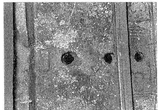
第12図 ケーシング(ドレン抜き孔部)の浸食、腐食
